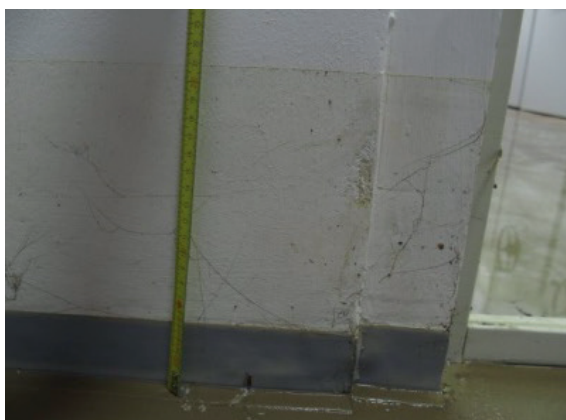
Slika 3: Arhivski prostoru se nahajajo v pol-kleti večnamenske stavbe, na posnetku vidimo do kod je segala voda ob poplavi. (foto: Judita Šega).
